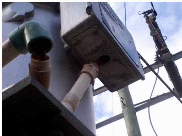
NORECO II – Loose conduit
